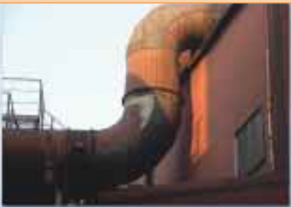
Коксовый завод Коленчатый патрубок
